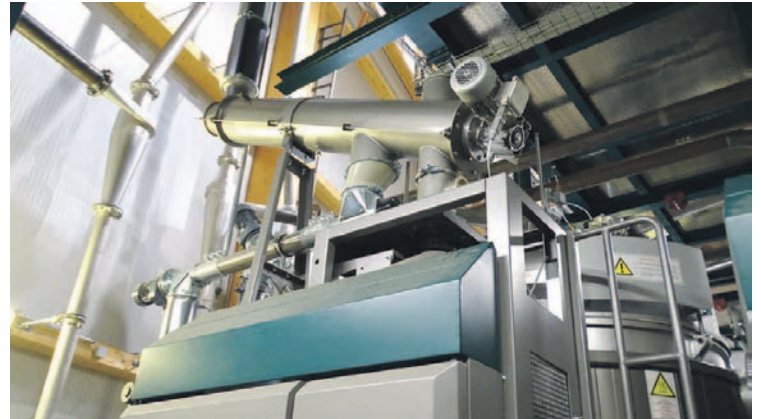
Die Anlage produziert jährlich vier Millionen kWh Strom für rund 1000 Haushalte.
